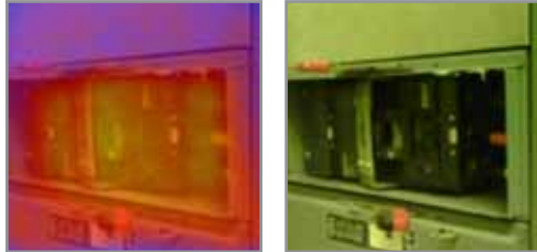
Temperatura de funcionamiento normal en disyuntor de misión crítica
