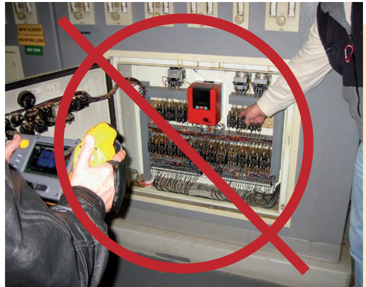
IR-Fusion elimina la arriesgada práctica de señalar con un dedo en un armario eléctrico el componente bajo estudio por sobrecalentamiento.
