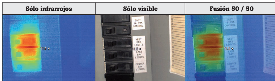
Figura 6. En una imagen combinada de luz visible e infrarrojos se pueden ver las etiquetas de los equipos y las zonas problemáticas
